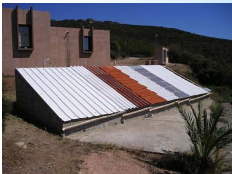
Prototype P3 (40 m 2 ) - toitures actives pour la condensation de vapeur d'eau et climatisation passive de bâtiments par l'utilisation des peintures radiatives brevetées (Laboratoire U. de Corse - Ajaccio)
